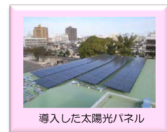
太陽光システムパネルの表示
